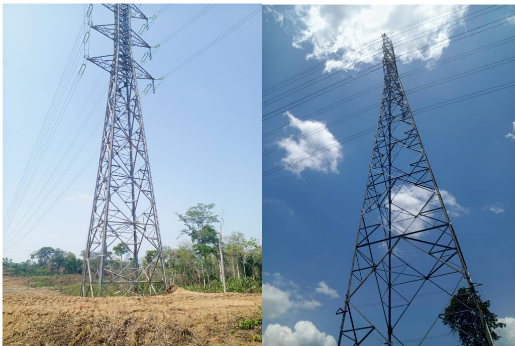
Ligne 2*225kV Nachtigal – Nyom II
