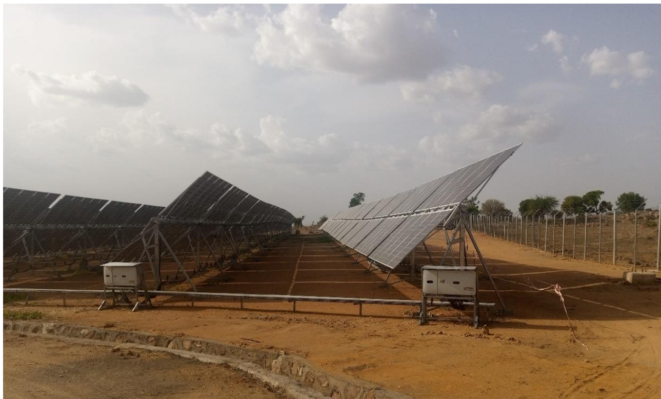
Champ solaire de la centrale de Guider, 15MW
