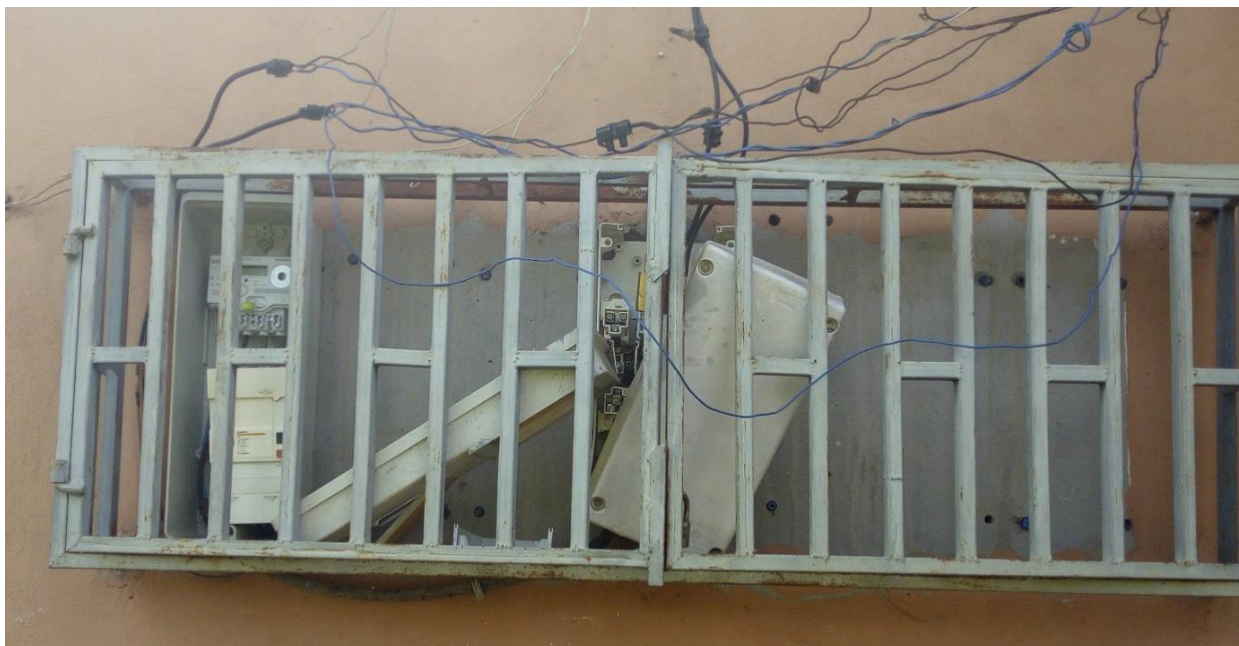
Installations électriques litigieuses
