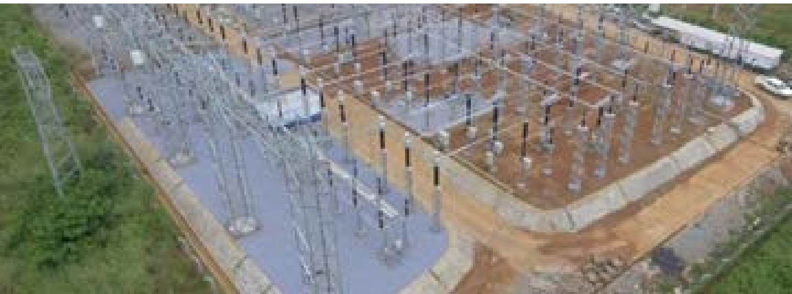
Le poste de transformation de Nkolnkoumou
